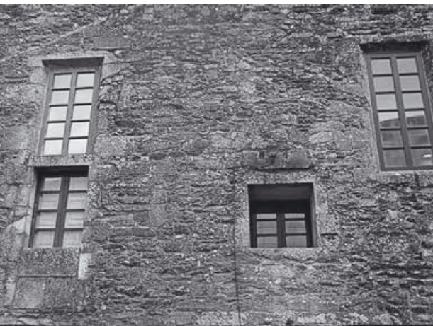
(Fig. 18) Fotografía actual da fachada da ala oeste do convento. Primeiro plano da xanela –lado esquerdo– convertida en porta para comunicar a nova cociña de 1883 e o comedor do hospicio. A xanela de forma cadrada –lado dereito– construída para pasar a comida directamente ao comedor. (Fotografía da autora)
